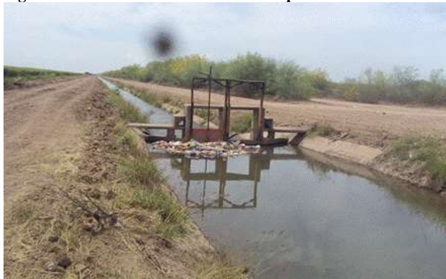
Figura 28. Foto de canal con desechos de plásticos detenidos en la compuerta.
