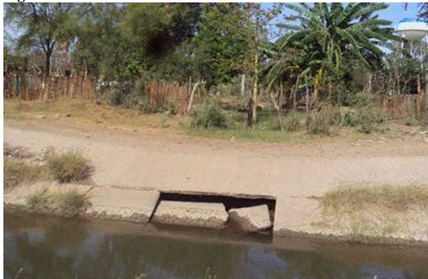
Figura 29. Foto de canal revestido de concreto con daños en su estructura.
